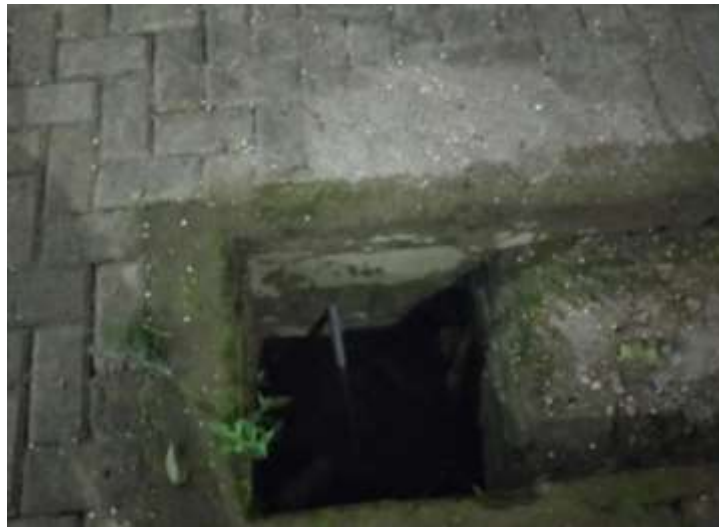
Gambar 2 Penggunaan Paving Block Dan Selokan Di Pekarangan Universitas Sunan Bonang.
