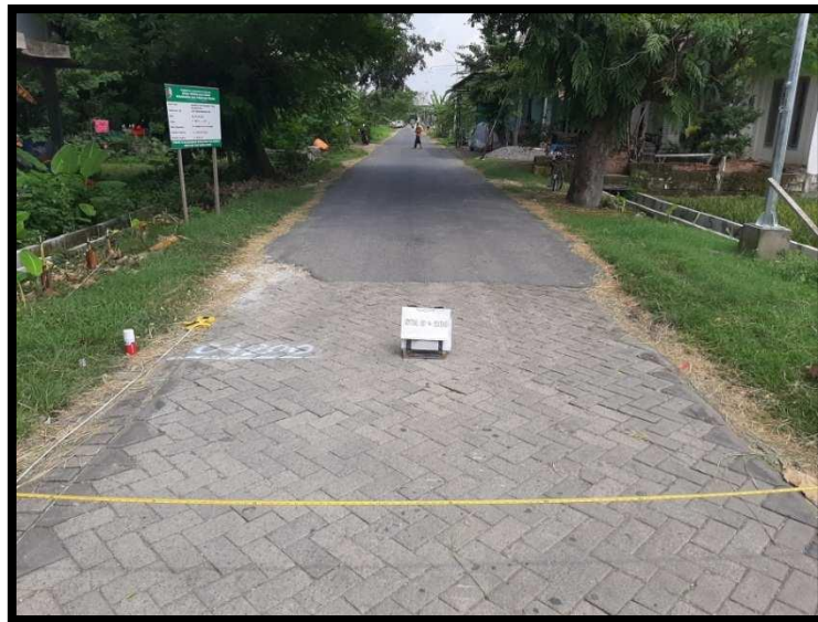
Gambar 1.1 Kerusakan pada Ruas Jalan Mayangkawis – Kenep
