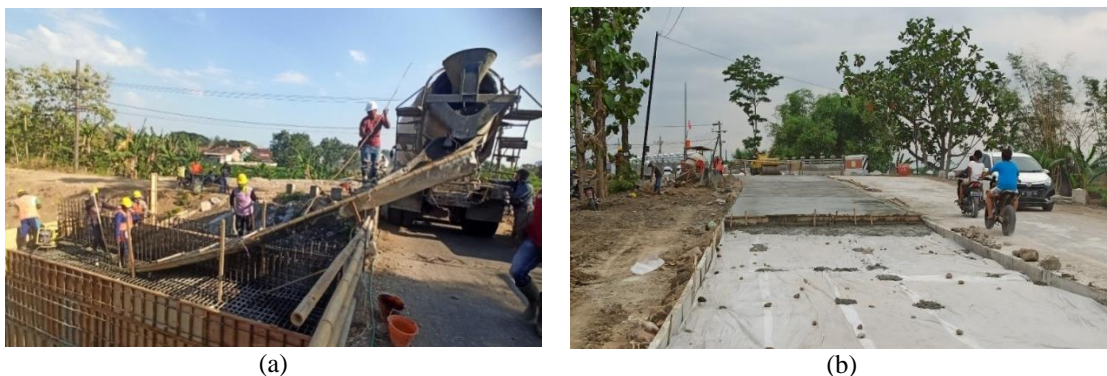
(a) (b) Gambar 2. (a) Proses pengecoran abutmen Jembatan, (b) Proses pengecoran pelebaran jalan
